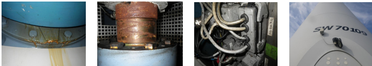
Detailbilder der neu erworbenen Nordex S 77-WEA in Hinterweiler vor der Sanierung durch StiegeWind
